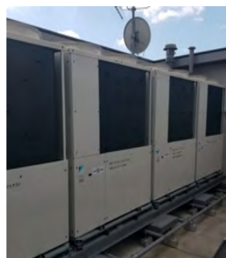
GHP(ガスヒートポンプエアコン)
