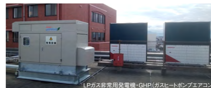
LPガス非常用発電機・GHP (ガスヒートポンプエアコン)
