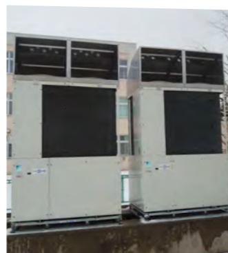
GHP(ガスヒートポンプエアコン)
