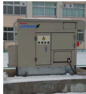
LPガス非常用発電機
