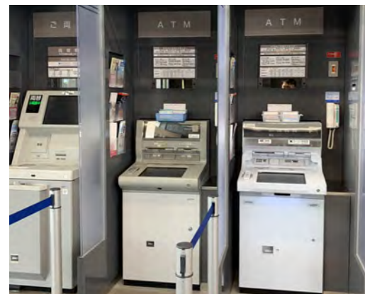
非常時も稼働可能になったATM
