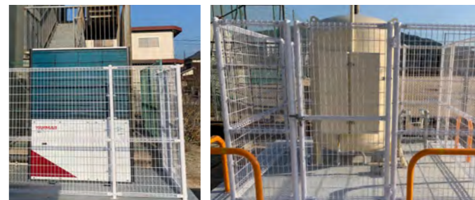
GHP(ガスヒートポンプエアコン) LPガスバルク
