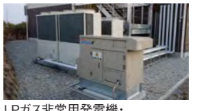
LPガス非常用発電機・GHP(ガスヒートポンプエアコン)
