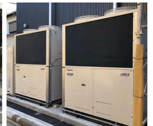
GHP(ガスヒートポンプエアコン)
