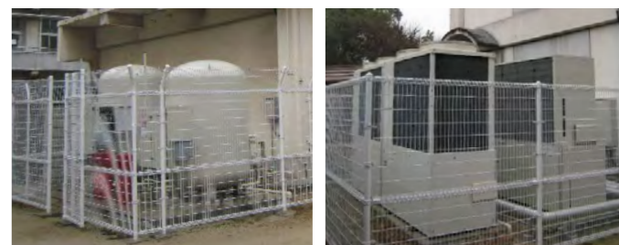
LPガス災害バルク GHP(ガスヒートポンプエアコン) (上記のLPガス災害バルクと電源自立型GHPは、避難所に指定している市内中学校6校・小学校7校に設置しています。)
