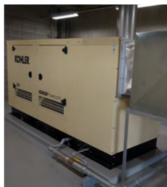
LPガス非常用発電機
