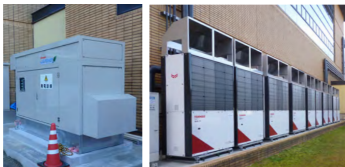
LPガス非常用発電機 GHP(ガスヒートポンプエアコン)
