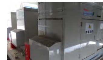
LPガス非常用発電機
